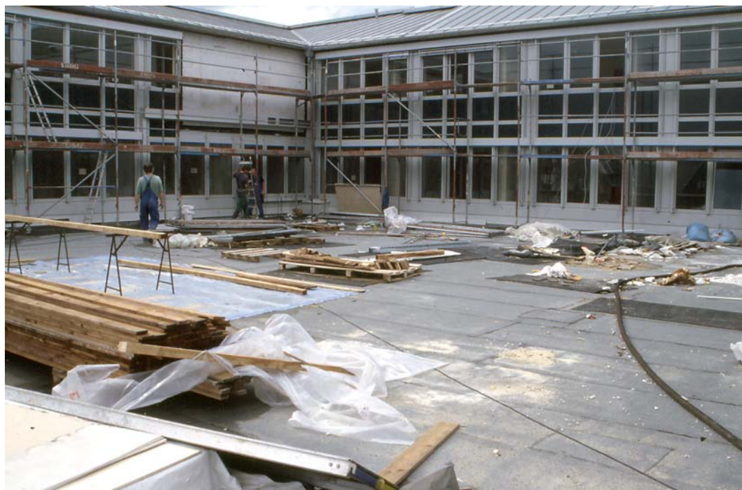
Abb. 3: Erhöhtes Gefährdungspotential durch fremde Gewerke und unsachgemäße Lagerung von Baumaterialien (Quellen: Deutscher Dachgärtner Verband )
