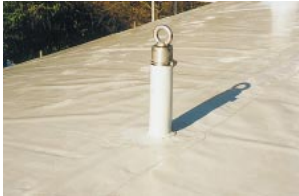
Der Anschlagpunkt für Absturzsicherung ist gut sichtbar.
